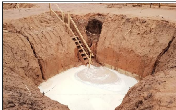
Figura 2. Erosões localizadas nos taludes da escavação após precipitação Fonte: Autoria própria (2025)
